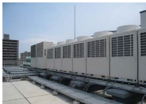
機械棟 空調設備
