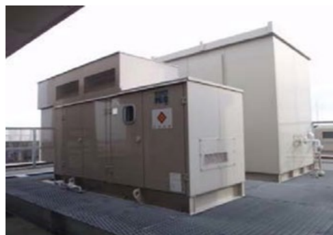
情報センター院生棟 自家発電装置
