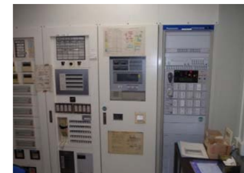
共通講義棟 防災受信盤
