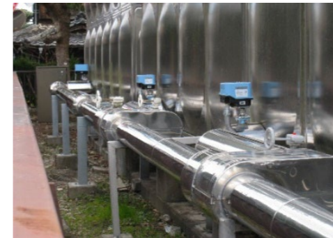
受水槽 緊急遮断弁
