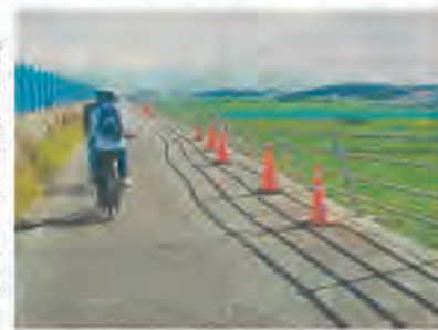
転落防止策が傾いているのを確認する県職員。2021年7月、鳴門市里浦町里浦
