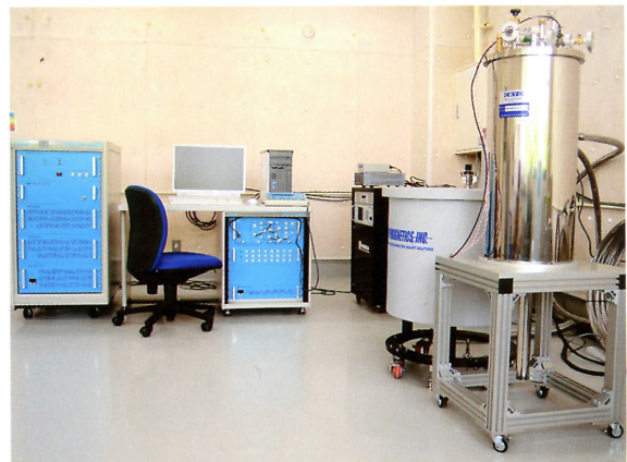
設置機器一例（NMR システム）
